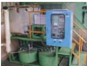
ジクロロメタンの再生施設
