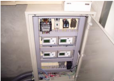
電力モニタリングシステム
