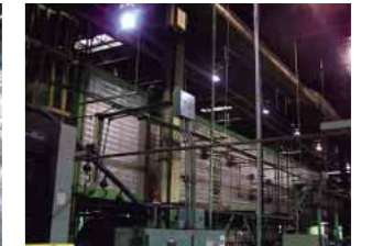
工場照明を水銀灯から蛍光灯へ切り換えた高効率の照明(NASCO)
