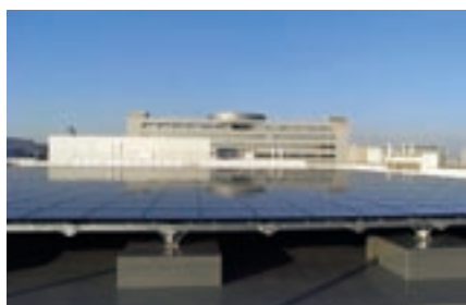
横浜事業所太陽光発電装置(100kW) (2009年2月から稼働)
