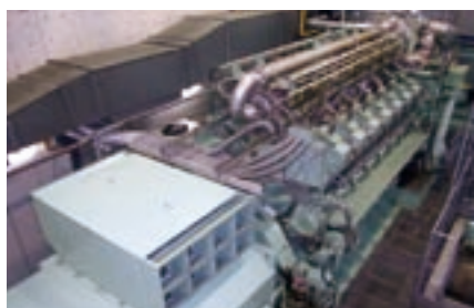
2005年2月から稼働している横浜事業所コージェネ発電装置(4,450kW)
