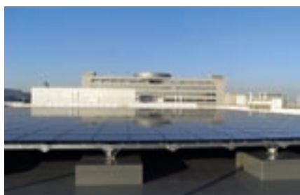
横浜事業所太陽光発電装置(100kW) (2009年2月から稼働)
