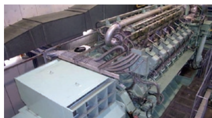
横浜事業所 コージェネ発電装置 (4,450kW) 2005年稼働開始
