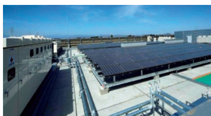
シート群馬工場 (56kW) 2012年稼働開始
