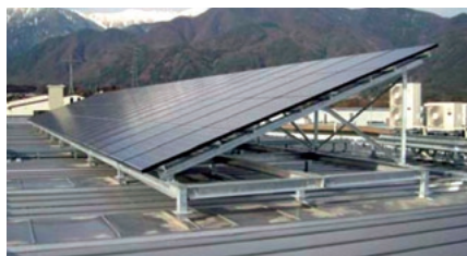
DDS駒ヶ根工場 (20kW) 2008年稼働開始
