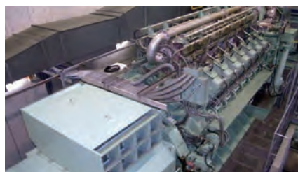
横浜事業所のコージェネレーション発電設備 (4,450kW) 2005年稼働開始
