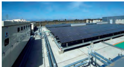
シート群馬工場 (56kW) 2012年稼働開始
