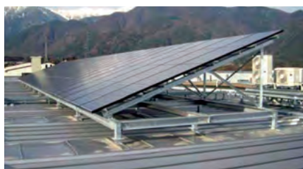
DDS駒ヶ根工場 (20kW) 2008年稼働開始
